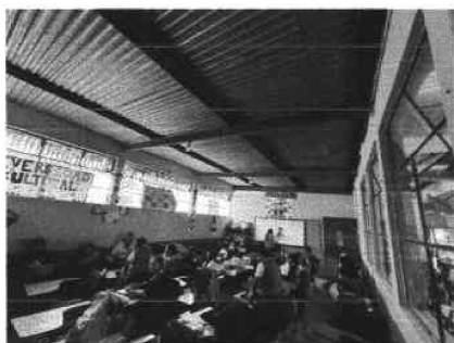
Foto 5: ESTRUCTURA METALICA CON OXIDO, MALOS TRASLAPES EN LAMINAS
