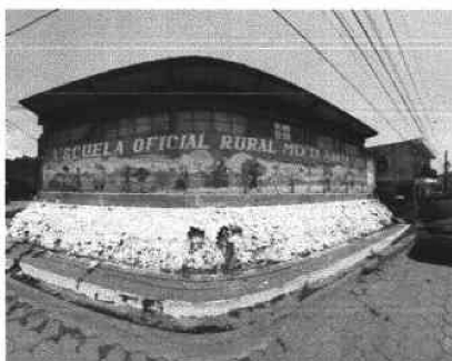
Foto 1: EL TALUD DE PIDRA QUE TIENE LA FACHADA SOBRE LA CALLE PRINCIPAL PRESENTA DESPRENDIMIENTOS
