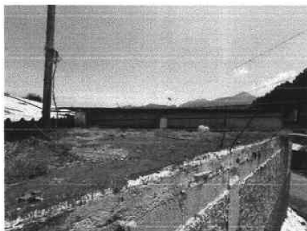
Foto 3: LA LOSA FUNDIDA DEL ÁREA DE BODEGA DEL INGRESO PRESENTA HUMEDAD Y CARECE DE BAJADAS DE AGUA
