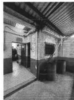
Foto 4: HUMEDAD EN LOSA, BAJADAS DE AGUA PLUVIAL DAÑADAS, LAMINAS DETERIORADAS, ESTRUCTURA CON CORROSIÓN
