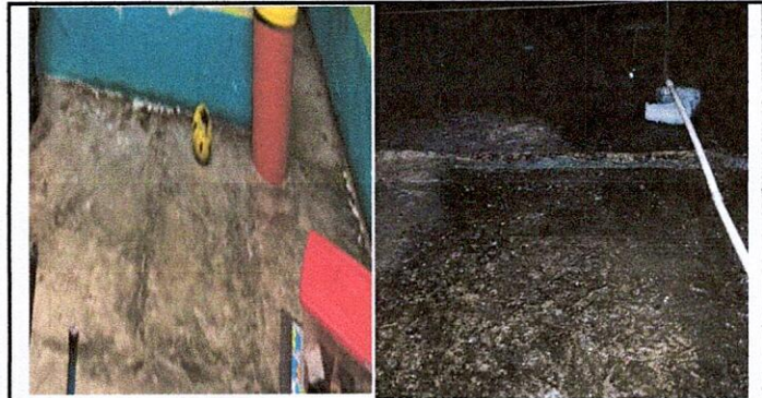
Foto 4: reparación de red de drenaje y red de agua potable. 14.6 limpieza de fosa séptica
