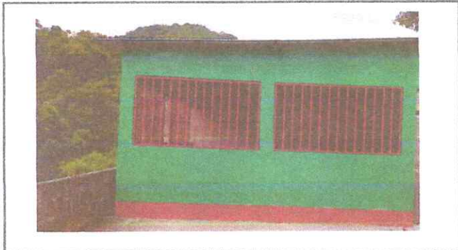
Foto1: 1-CUBIERTA DE LÁMINA 1.1 Sustitución de lámina, por lámina troquelada aluzinc. 1.3 Sustitución de elementos de fijación
