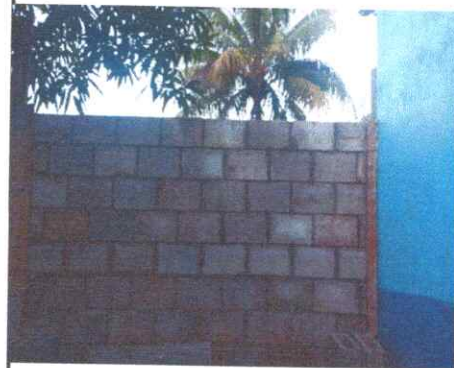
Foto 4: muro del lado derecho frente la escuela
