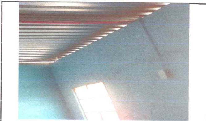
Foto: 7: Instalacion de unidad de luz ( incluye interruptor, ducto y cable electrico)
