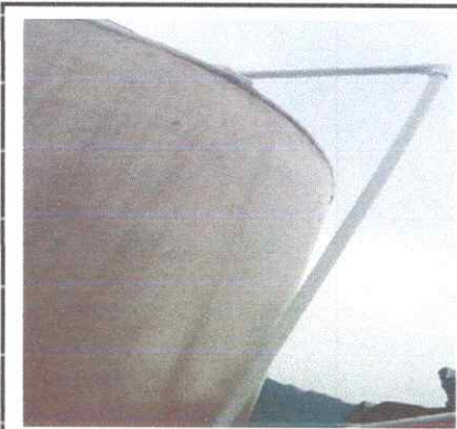
Foto: 8: Instalacion de red de agua potable para tinaco, 9 mts lineales y accesorios para tinaco.
