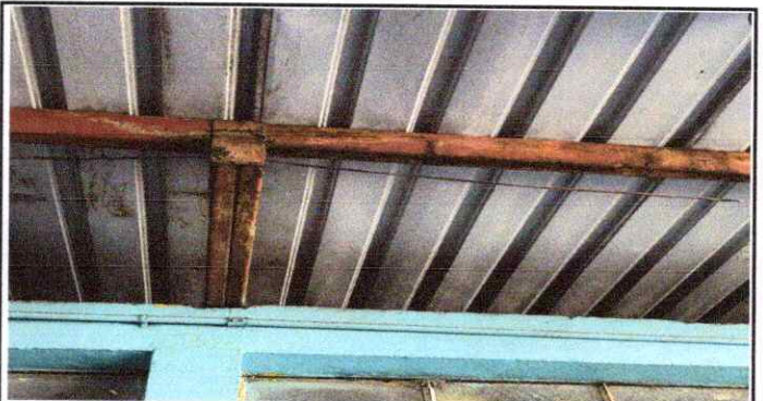
Foto 10: Sustitución de estructura de soporte de metal, ya que esta en muy mal estado.
