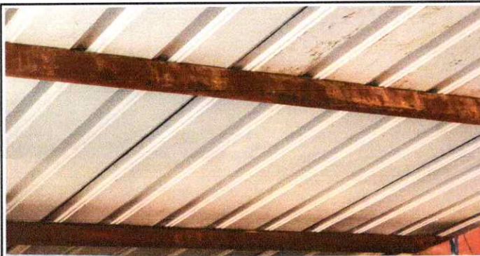
Foto 3: Mantenimiento a estructura de soporte de metal, que presenta daños.
