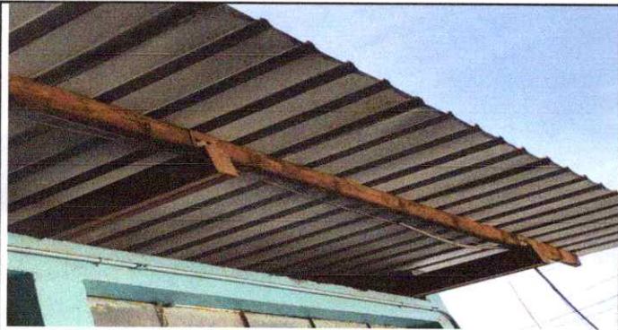
Foto 9: Sustitución de estructura de soporte de metal, ya que esta en muy mal estado.
