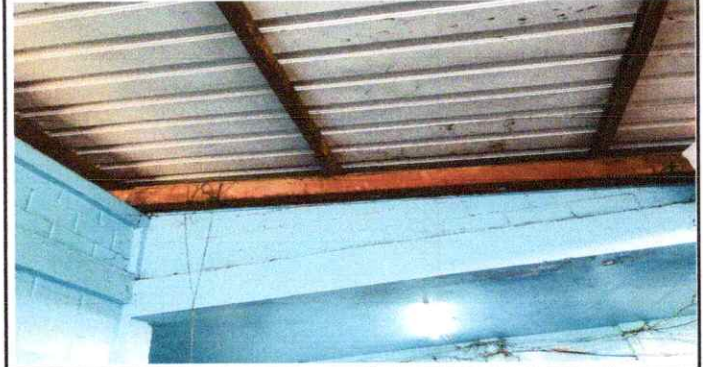
Foto 2: Mantenimiento a estructura de soporte de metal, ya que presenta daños.
