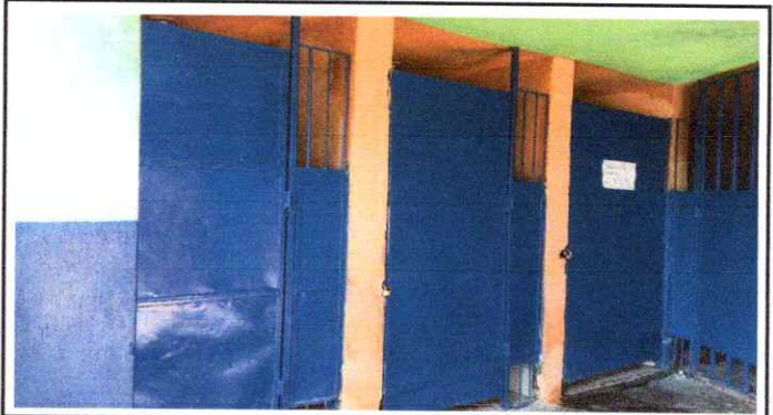
Foto 8: Área de sanitarios que requieren instalación de unidades de luz y sustitución de accesorios de inodoro.
