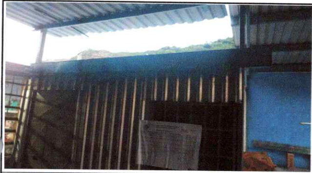
Foto 13: inicio de bajada de agua plubial de metal por tuvo PVC
