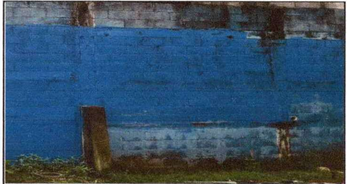
Foto 2: Pintura en muro perimetral, área exterior
