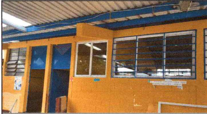
Foto1: Pendiente ventana, área de sanitarios.
