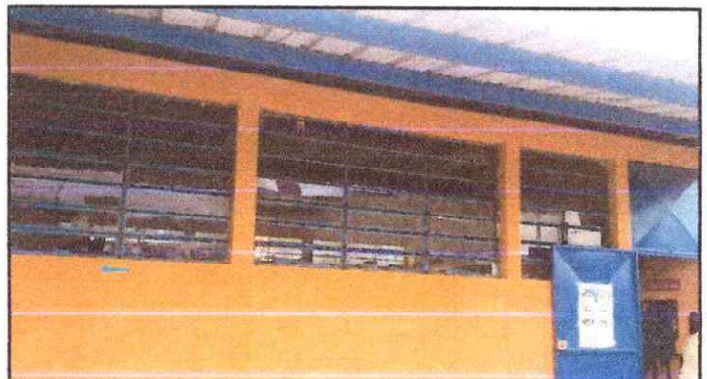
Foto 4: Mantenimiento en estructura de metal de ventana que se utilizará como balcon.
