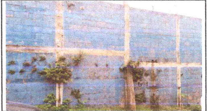
Foto 2: Pintura en muro perimetral
