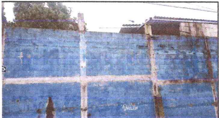
Foto 4: Pintura en muro perimetral
