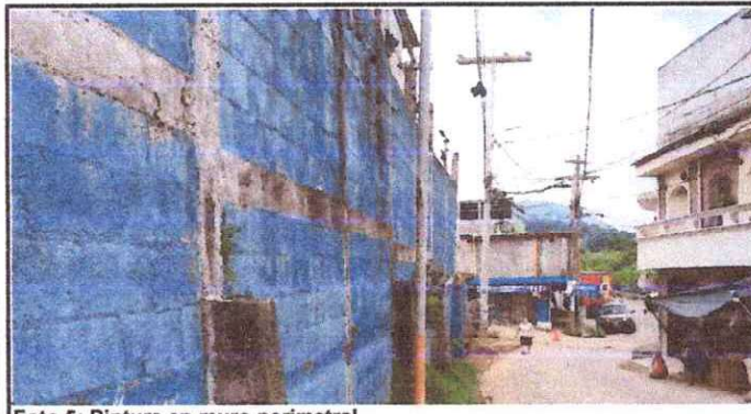
Foto 5: Pintura en muro perimetral
