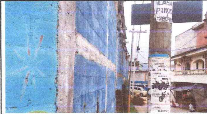
FOTO 1: Pintura en muro perimetral
