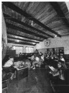
Foto 3: LAMINAS DEL MÓDULO DE AULAS EN MAL ESTADO
