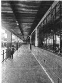
Foto1: LAMINAS EN MALAS CONDICIONES, ESTRUCTURA METALICA EN BUEN ESTADO
