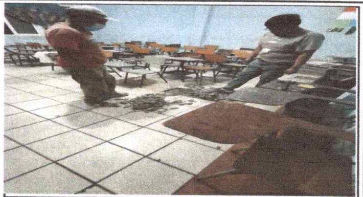
Foto 2: Sustrucción de piso cerámico.
