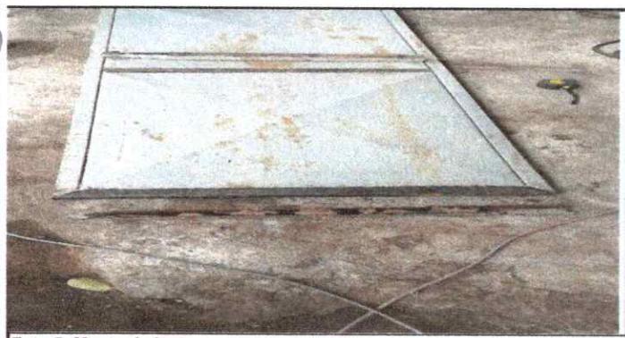
Foto 5: Mantenimiento a estructura, (lijado, cambio de tubo, cepillado, sujeciones, aplicación de pintura)
