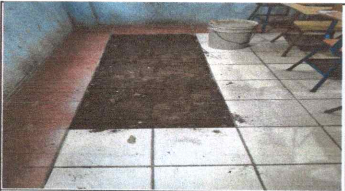
Foto 3: Sustrucción de piso cerámico.
