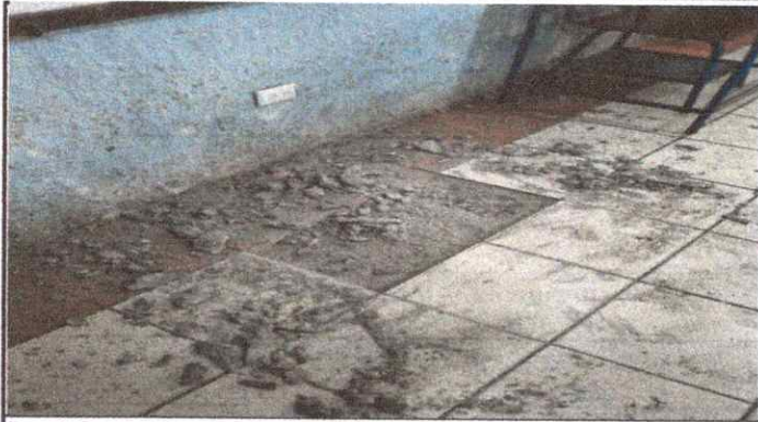
Foto 1: Sustrucción de piso cerámico.
