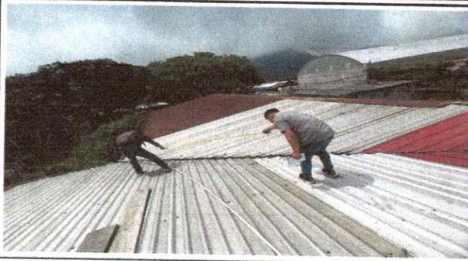
Foto1: Sustitución de Canal pluvial deteriorado por ser de material metalico que se oxidó rapido.
