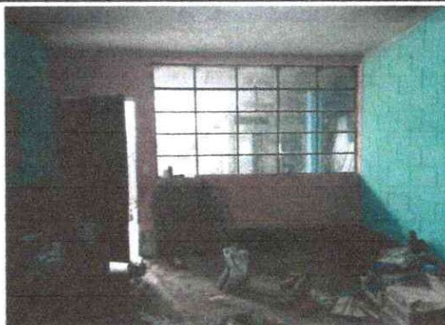
Foto 2: Necesario repellar muros, sustituir piso y pintar muros. Salón 1.
