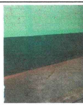
Foto 6: Necesario repellar muros, sustituir piso y pintar muros. Salón 4
