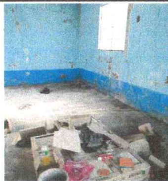
Foto 4: Necesario repellar muros, sustituir piso y pintar muros. Salón 3.
