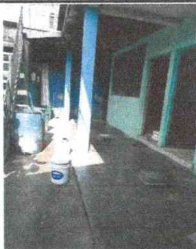
Foto 1: Necesario sustituir piso, en el corredor del establecimiento.
