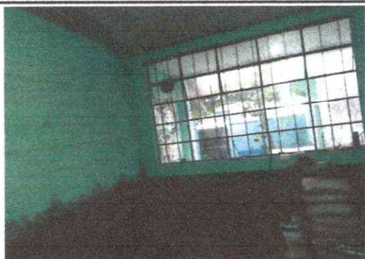
Foto 3: Necesario repellar muros, sustituir piso y pintar muros. Salón 2.
