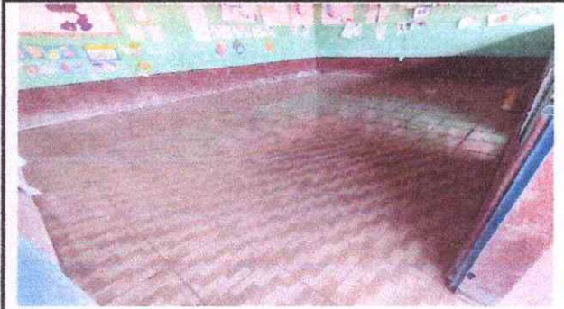
Foto 2: Sustrucción de piso cerámico.
