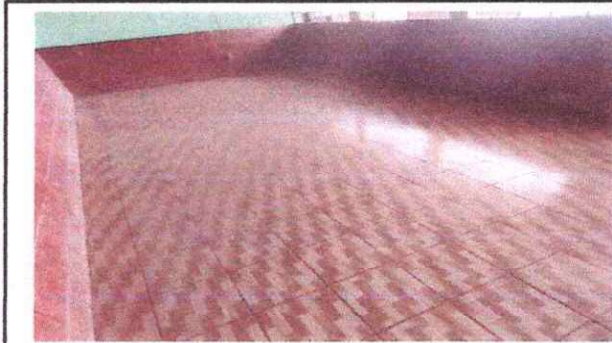
Foto 1: Sustrucción de piso cerámico.
