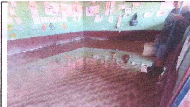
Foto 3: Sustrucción de piso cerámico.
