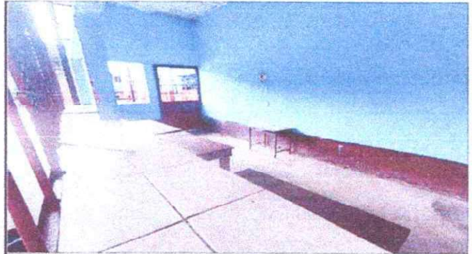
Foto 20: Mantenimiento a estructura, (lijado, cambio de tubo, cepillado, sujeciones, aplicación de pintura.
