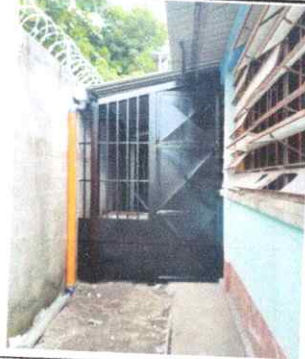
Foto 8: Area de cocina sin techo, Regiones 19.7, 18.8 (Intalacion de estructura portante de metal, Instalacion de lamina troquelada aluzinc calibre 26)
