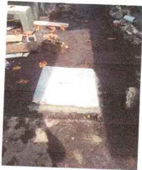
Foto 9: Drenaje colapsado, Region 19.18 (Instalacion de tubería principal PVC)
