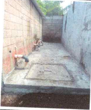
Foto 7: Tapadera de fosa septica dañada, Region 14.5 (Reparacion de tapaderas de cajas)
