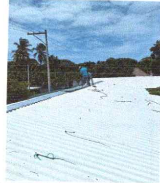
Foto 2: Capote en mal estado, Reglon 1.2 (Sustitucion de capote para lamina troquelada).
