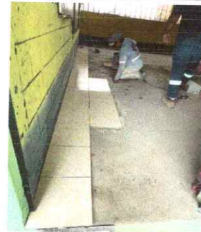
Foto 6: Piso en mal estado, Reglon 6.8 (Sustitucion de piso ceramico).
