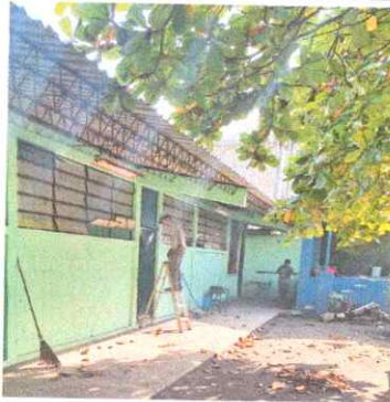
Foto 3: Puertas en mal estado, Reglon 4.1 (Mantenimiento a estructura)
