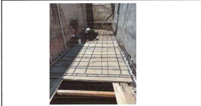
Foto7: Tapadera de fosa septica dañada, Region 14.5 (Reparacion de tapaderas de cajas)
