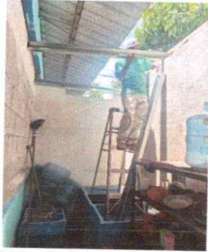
Foto 1: Lamina en mal estado, Reglon 1.1 (sustitucion de lamina por amina troquelada aluzinc calibre 26).
