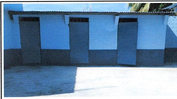
FOTO 4. SANITARIOS 4.1 Mantenimiento a estructura (lijado, cambio de tubo, cepillado, sujecciones, aplicación de pintura.)
