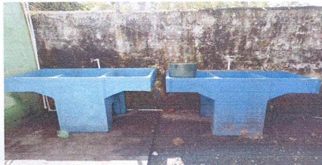
Foto 5: Pila en mal estado, Region 19.20 (Instalación de pila), Region 20.10 (Sustitución de pila de cemento de dos lavaderos).
