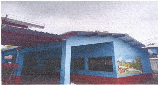
Foto 1: Enlaminado en mal estado, Region 1.1 (Sustitución de lamina por lamina troquelada aluzinc calibre 26), Region 1.3 (Sustitución de elementos de fijación), Region 19.8 (Instalación de lamina troquelada aluzinc) Region 19.10 (Desinstalación de lamina existente).
