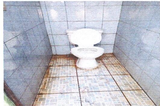
Foto 4: Inodoros en mal estado, Region 10.3 (Sustitución de inodoro), Region 19.15 (Instalación de inodoro).
