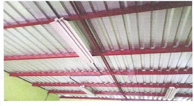
Foto 2: Estructura portante deteriorada, Region 2.1 (Mantenimiento de estructura de metal)
