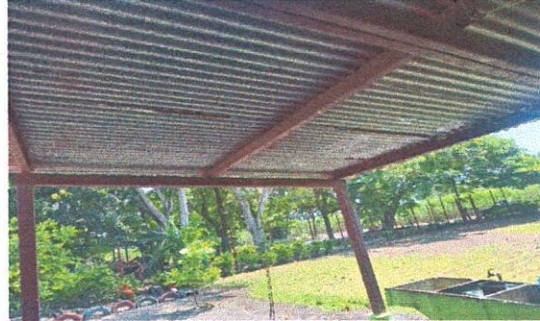
Foto 2: Estructura deteriorada, Region 2.1 (Mantenimiento a estructura de soporte de metal). Region 1.3 (Sustitución de elementos de fijación).
