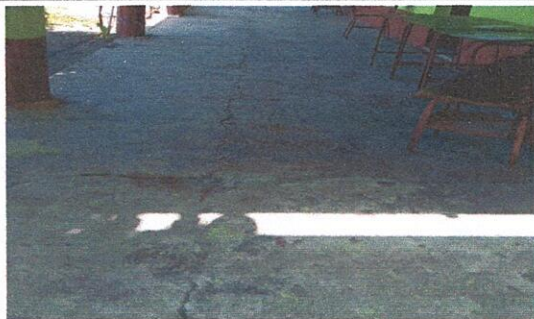
Foto 3: Piso en mal estado, Region 6.8 (Sustitucion de piso ceramico).
