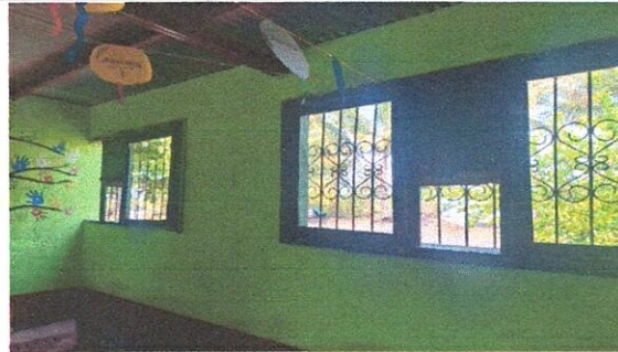
Foto 4: Ventanas de madera podridas, Region 5.3 (Sustitución de ventanas de madera por metal mas vidrio) Region 19.1 (Fabricación e instalación de ventana-balcon de metal)
