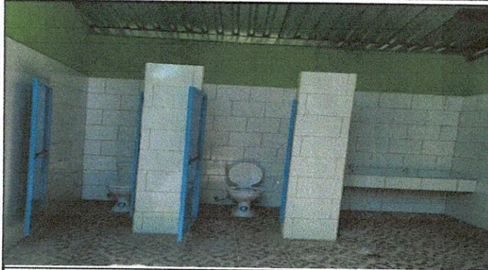
Foto7: 10 SERVICIOS SANITARIOS Y SUS ACCESORIOS
