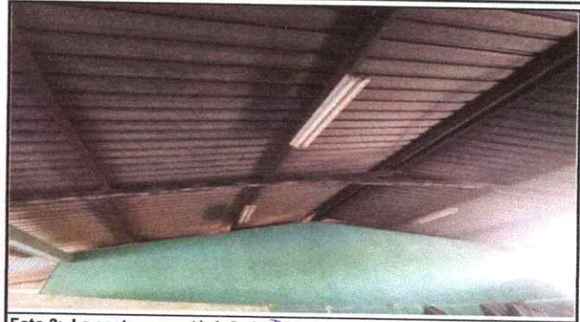
Foto 2: La costanera está dañada. 2.3
