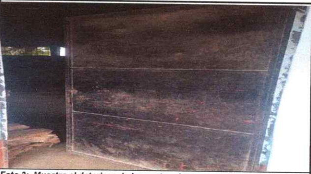
Foto 3: Muestra el deterioro de la puerta. 4
