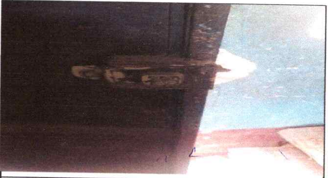
Foto 4: Ahi muestra la necesidad del cambio de chapa. 4.2
