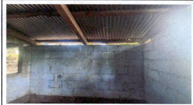
Foto7: .Techo de aula en mal estado y sin finalizar
