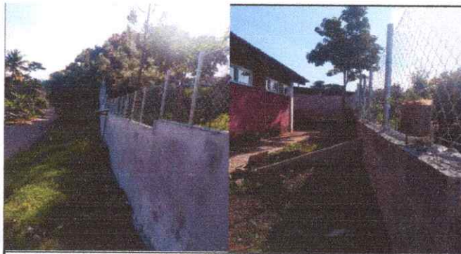
Foto 17 y 18: reparación de muro perimetral de block y reparación de tubo hg malla garbanizad
