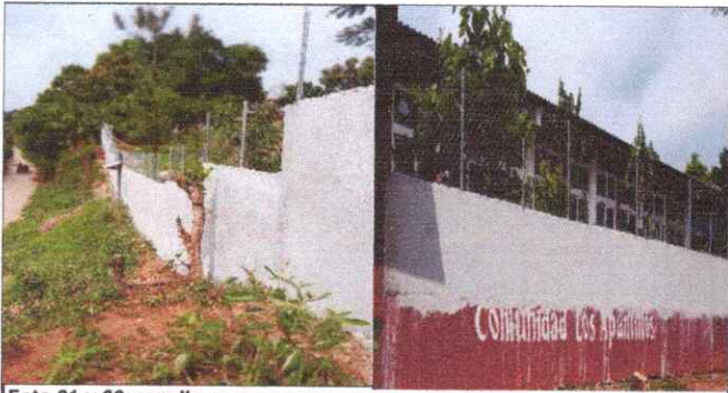
Foto 21 y 22: repello en muro
