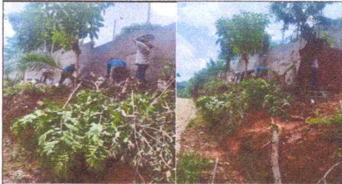
Foto 26 y 27: Repello en muro
