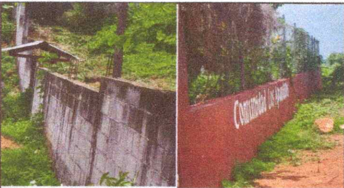
Foto 14 y 15: repello en muro
