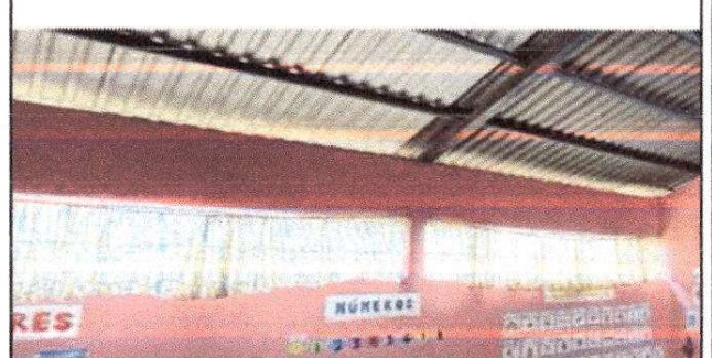
Foto 12: EL MURO NO LLEGA HASTA EL TECHO,
