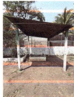
Foto 8: LA MALLA DEL MURO PERIMETRAL ESTÁ DAÑADA, PINTURA EN MAL ESTADO
