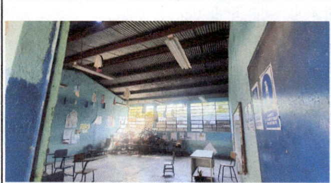
Foto 8: Techo de aula con estructura en mal estado
