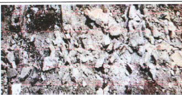
Foto 6: Sustrucción de piso de torta de concreto
