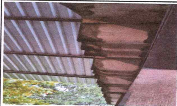
FOTO 6: 7 CANALES Y BAJADAS DE AGUA PLUVIAL 7.2 Sustitución de canal de PVC. 7.4 Sustitución de bajada de agua pluvial de metal por tubo PVC 3" 7.5 Sustitución de soporte o pescante de metal para canal.
