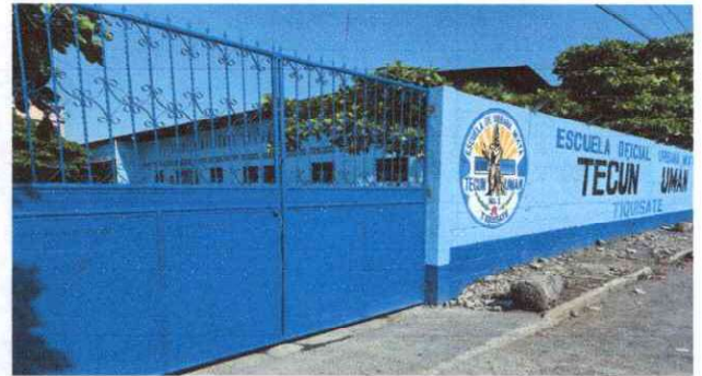
Foto 6: 19 MANO DE OBRA ESPECIALIZADA (ALBAÑILERÍA, HERRERIA, ELECTRICIDAD Y PLOMERIA) 19.5 Fabricación e instalación de portón de metal de ingreso
