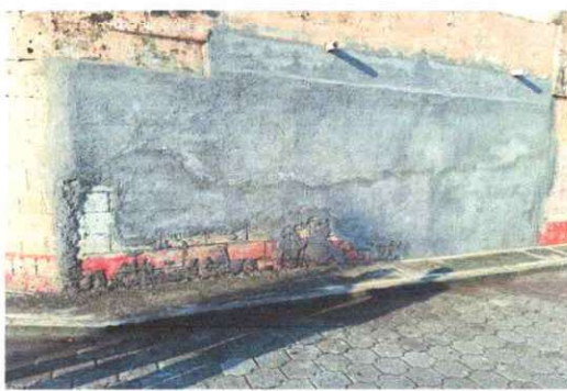
Foto 7: 21 REPARACION DE REPELLO Y CERNIDO DE PAREDES (CUANDO APLIQUE) 21.1 Repello en muro
