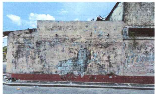
Foto 8: 21 REPARACION DE REPELLO Y CERNIDO DE PAREDES (CUANDO APLIQUE) 21.1 Repello en muro
