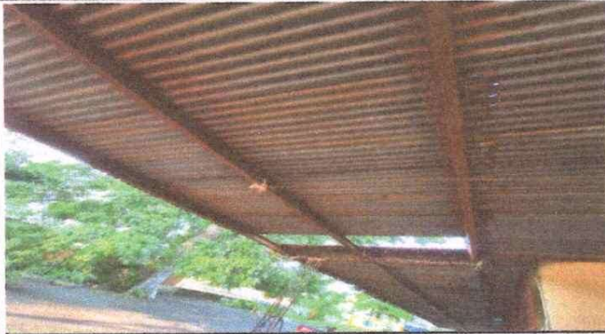
Foto1: 1. cubierta de lamina, 1.1. sustitucion de lámina, por lámiana troquelada aluzinc calibre 2, 1.2 sustitucione de capote para lámina troquelada, 1.3 sustitución de elemento de fijación
