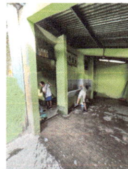
Foto 10: NO TIENEN INSTALACIONES ELECTRICAS EN EL MODULO DE BAOS
