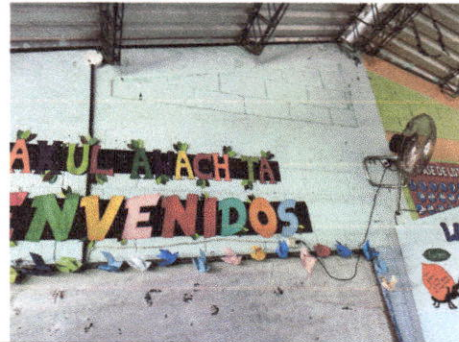
Foto 8: NO TIENEN INSTALACION ELECTRICA SOLO FUERZA
