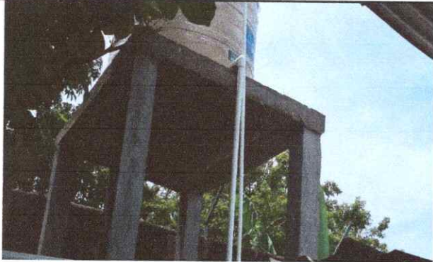
Foto 3: 18.3 Sustitución de deposito de agua 1700 lt 18.5 Sustitución de accesorios deposito de agua 18.7 Sustitución de bomba de agua
