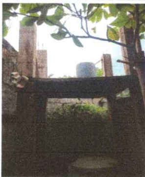
Foto 3: 18.3 Sustitución de deposito de agua 1700 lt 18.5 Sustitución de accesorios deposito de agua 18.7 Sustitución de bomba de agua
