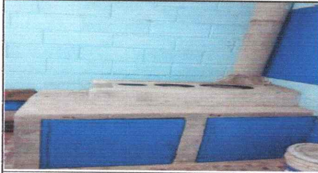
20.3 Sustitución de plancha de metal de 3 hornillas. 20.8 Reparación de azulejo en muebles de cocina.
