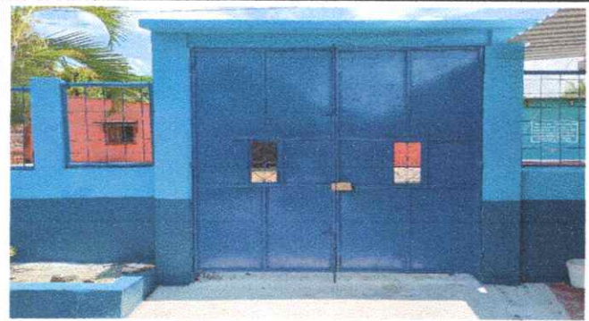
Foto3: MUROS PERIMETRALES. 15.2 Reparación de muro perimetral de block con tubo hg y malla galvanizada, soleras intermedias y columnas
