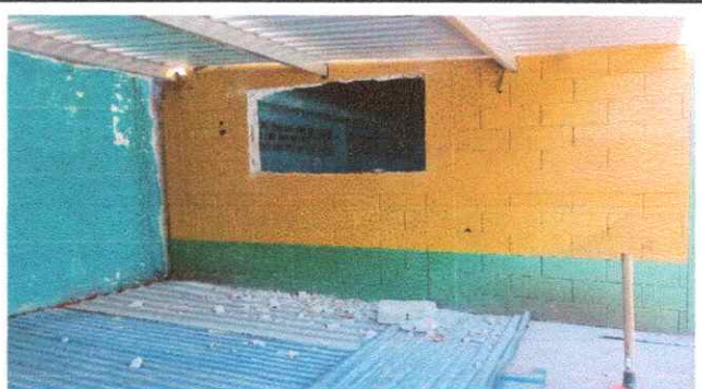
Foto4: MANO DE OBRA ESPECIALIZADA HERRERÍA. 19.1 Fabricación e instalación de ventana-balcon de metal
