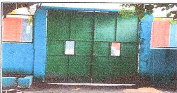
Foto 3: MUROS PERIMETRALES. 15.2. Reparación de muro perimetral de block con tuvo hg y malla galvanizada, soleras intermedias y columnas.
