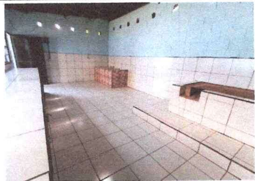
Foto 4: Sustrucción de azulejo en la cocina
