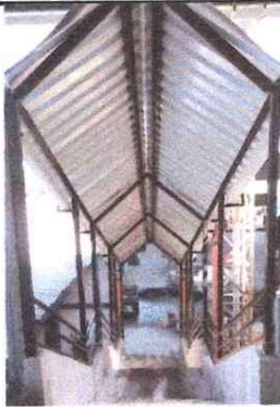
Foto 3: Sustrucción de baranda de metal
