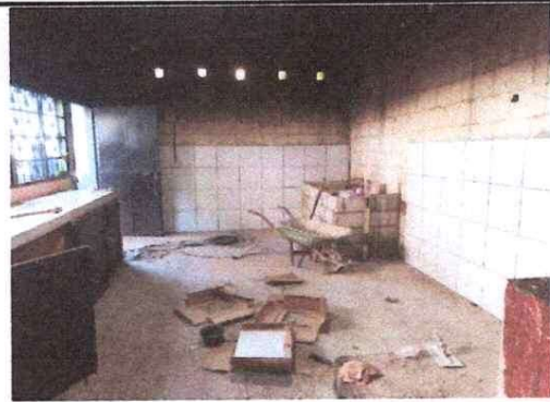
Foto 4: Sustrucción de azulejo en la cocina
