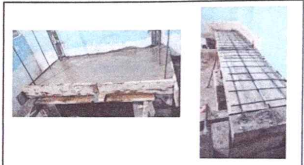
Foto 4: inicia trabajo de mantenimiento a cocina rural con chimenea y muebles de cocina azulejados
