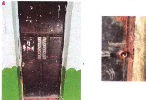
Foto 3: se observa daño en la estructura de puerta y chapa necesitando mantenimiento 12 puertas y el cambio de 5 chapas
