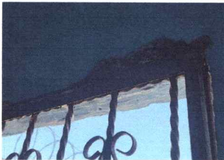
Foto 5: las ventanas de 3 salones se encuentran deteriorados por lo cual necesitan mantenimiento
