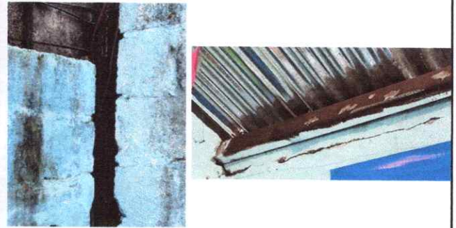
Foto 2: se observan daños en la estructura de las paredes de direccion y salones de clases
