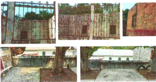
Foto 3: Reparación de balcones y colocación de barandal para el reguardo de los estudiantes.
