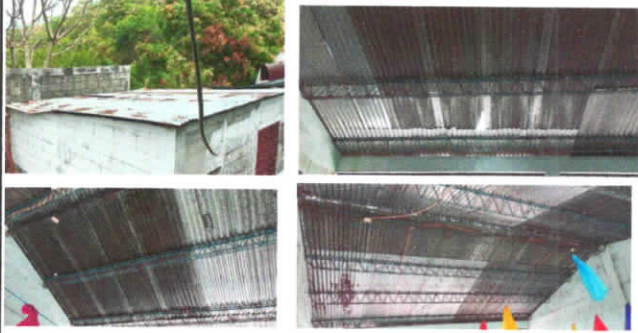
Foto 1: El techado se encuentra en mal estado, con picaduras y láminas levantadas por el aire que azota en la comunidad.
