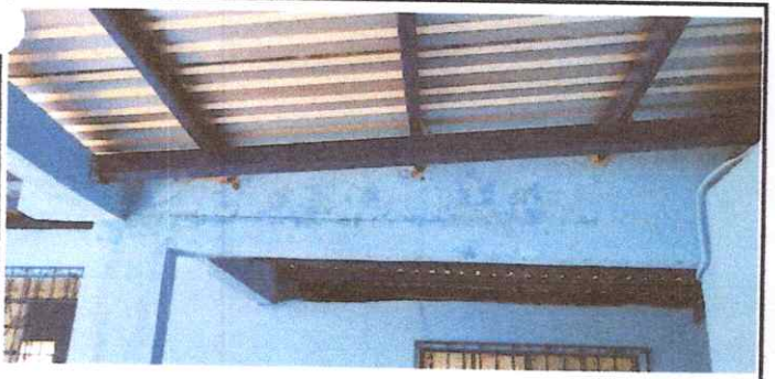
Foto 11: ESTRUCTURA DE TECHO 2.3. Sustitucion de estructura de soporte de metal por metal.
