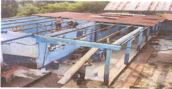
Foto 1. MANO DE OBRA ESPECIALIZADA ALBAÑILERÍA, HERRERÍA, ELECTRICIDAD Y PLOMERÍA 19.10. Desinstalacion de lámina existente
